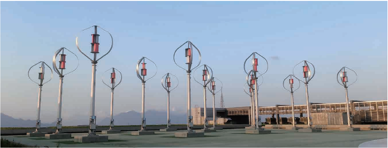
郵政物流園區風力發電設施
