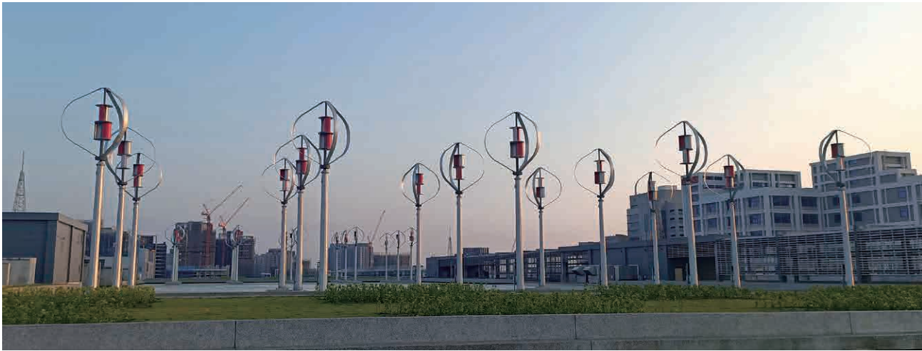
郵政物流園區風力發電設施
