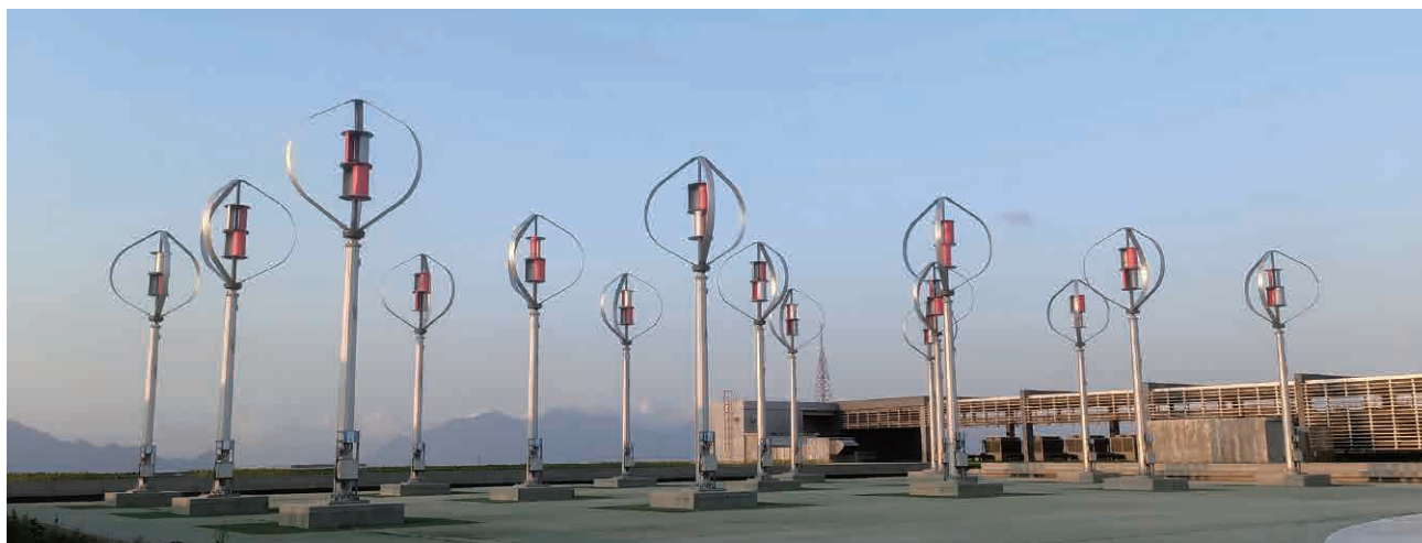
郵政物流園區風力發電設施
