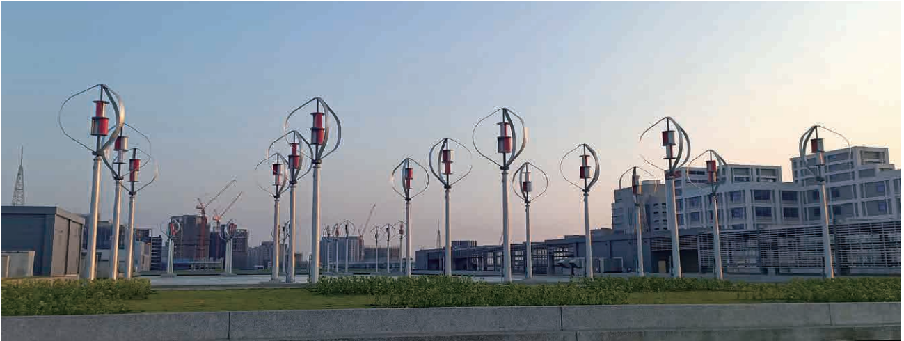
郵政物流園區風力發電設施
