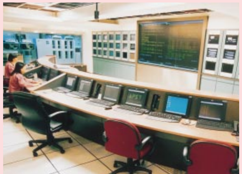
主控中心一景 A corner of the Control Center
